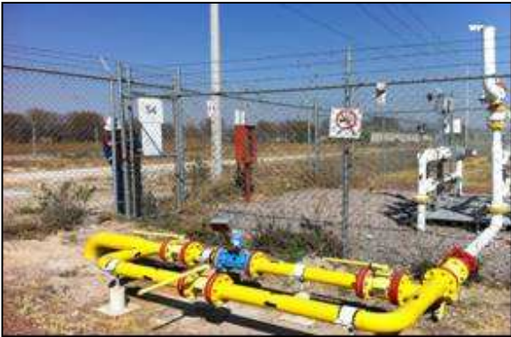
Imagen 6.- El Operador entra a la caseta y realiza el cierre de válvulas para controlar la emergencia.
