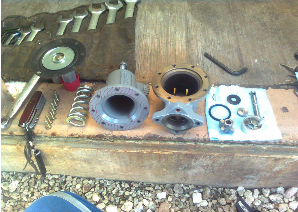
Vista de mantenimiento a los reguladores.
